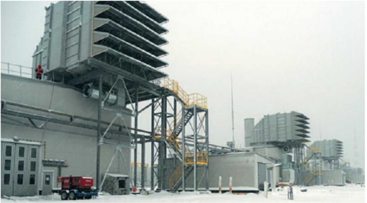
Рисунок 1.5 - КВОУ на компрессорной станции «Портовая» магистрального газопровода «Северный поток» [15]
