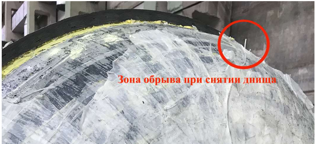
Рисунок 3.35 Обрыв оптоволоконной линии при снятии технологической рубашки в зоне днища.
