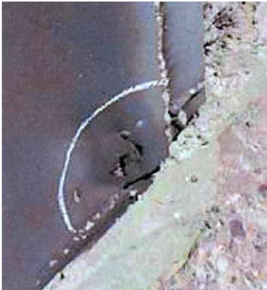
Рисунок 1.9 – Локальные разрушения газоотражателя
