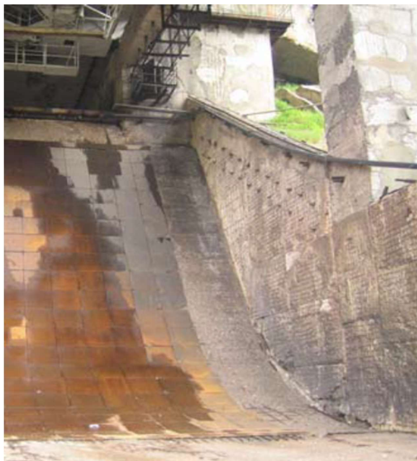
Рисунок 1.7 – Газоотводящий тракт РН КА типа «Союз» со следами теплового и эрозионного разрушения
