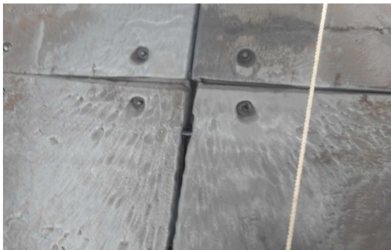
Рисунок 1.6 – Повреждения металлооблицовки при болтовом закреплении
