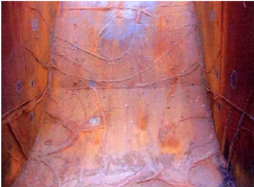
Рисунок 1.8 – Локальные разрушения газоотражателя
