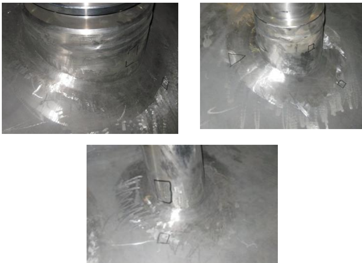
Рис. 6.11. Сварные соединения коллекторов с крышкой резервуара
